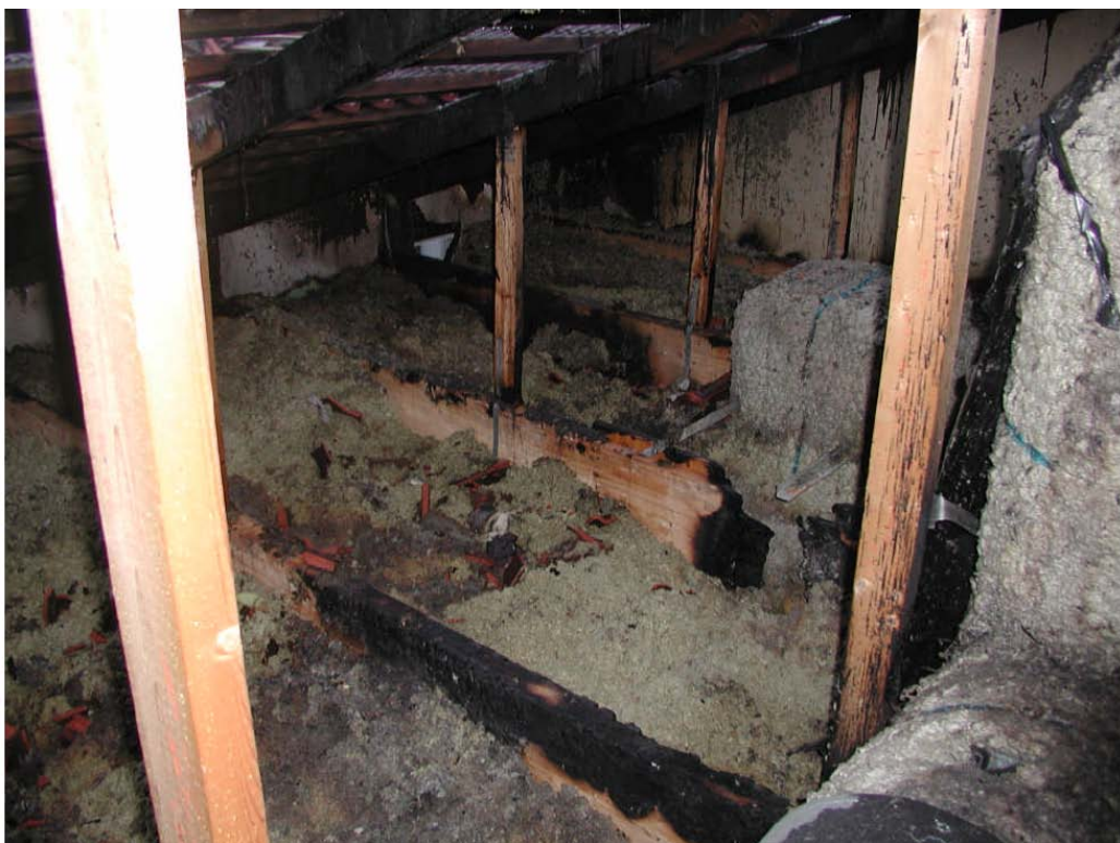
Figur A 3. Urbränningsskador på limträbalkar.
