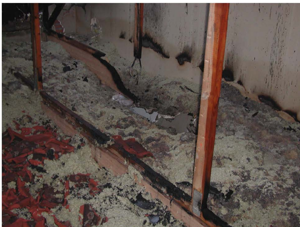
Figur A 4. Urbränningsskador på limträbalkar.
