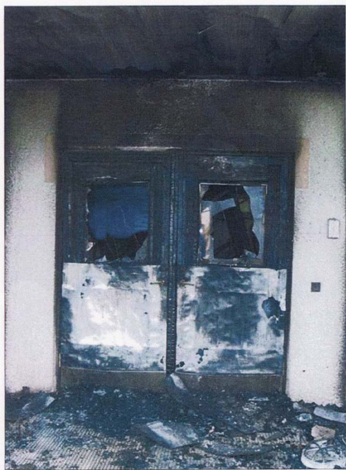
Figur B 2. Brandskadorna på dörrarna bedömdes vara sekundära
