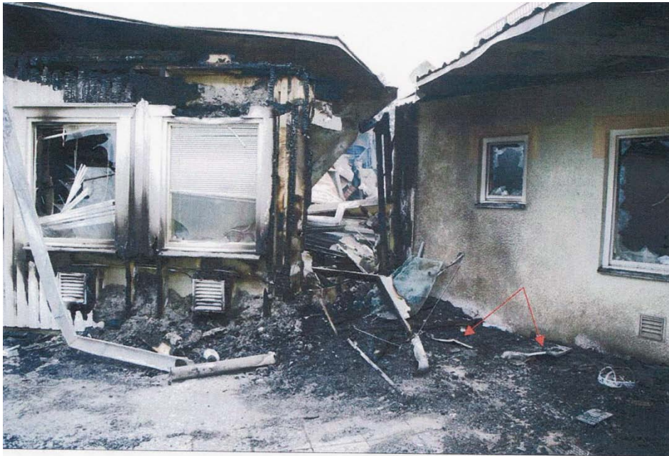
På bilden ses en plåt som kan ha tillhört en trälåda som stått på platsen. Markerat med pilar.
