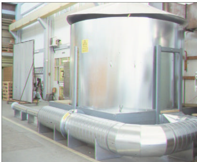
Bild L.3.1, "Cylindan", i cylinderns topp syns huvan som samlar upp rökgaserna. Rören framför och parallellt med golvet visar det monterade spiroröret som ska transportera blandningen av luft och släckmedel. Lägg märke till hur rörets diameter smalnar av vid inloppet.
