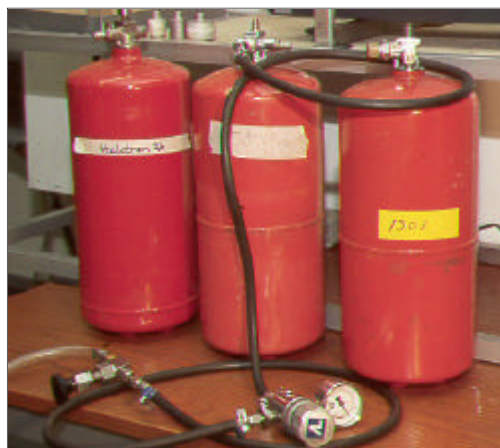
Bild H.8.2, Visar hur den nämnda tryckreduceringsventilen var monterad på en av flaskorna.
