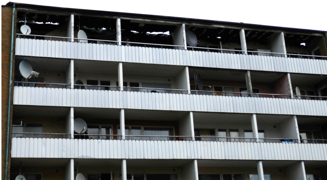
Bild som visar brandskador i taket på de översta balkongerna i byggnaden.
