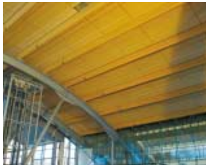
Invändiga paneler är ett lämpligt användningsområde för brandskyddat trä. Exempel från flygplatsen Gardemoen i Norge.
