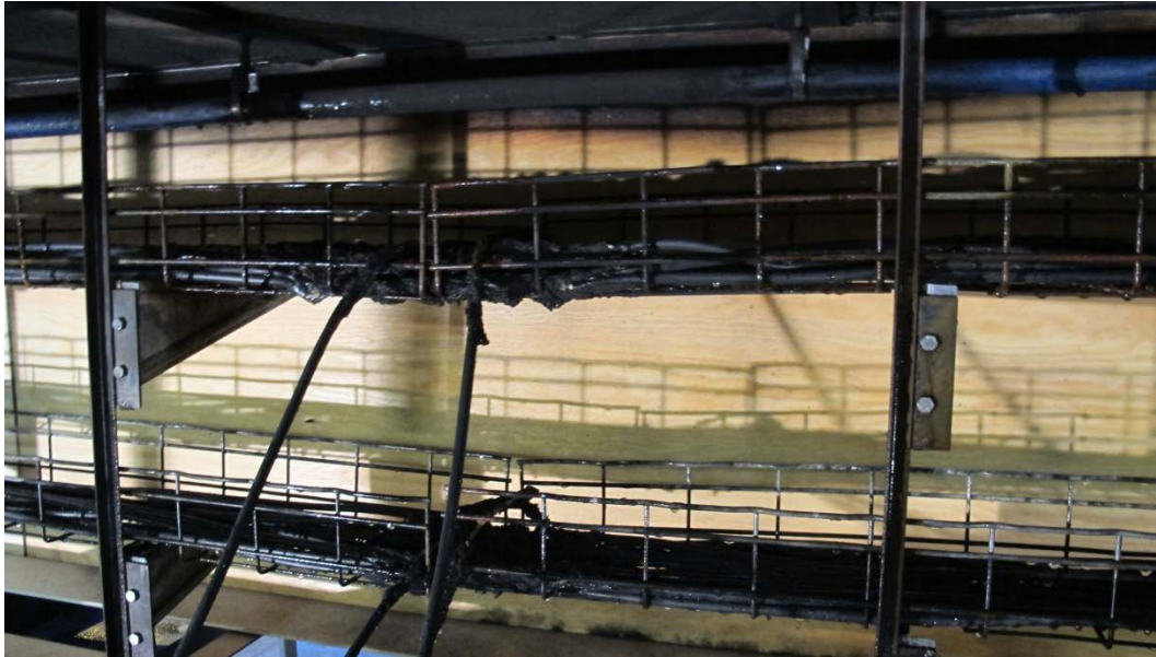
Figur 10 Brandskadorna i en försöksuppställning som simulerar undertak- och övergolvsutrymmen efter ett försök med ett lågtryckssystem. Foto publicerat med benäget tillstånd av tillverkaren.
