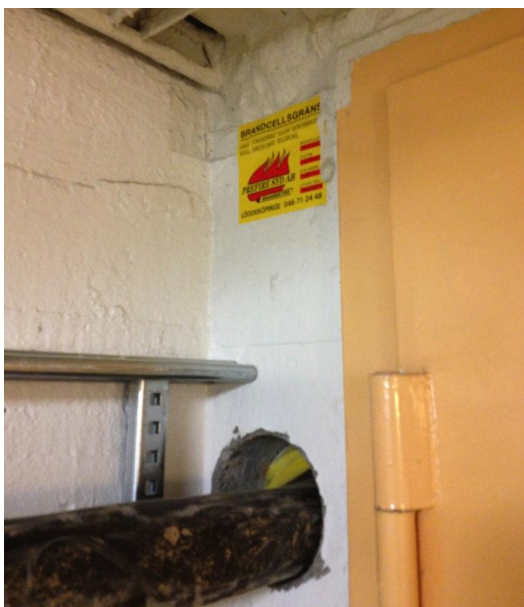
Bild 9: Brandcellgräns där genomföring blivit korrekt tätad men vid ett senare tillfälle har en ny håltagning gjorts vilken ej har blivit tätad.
