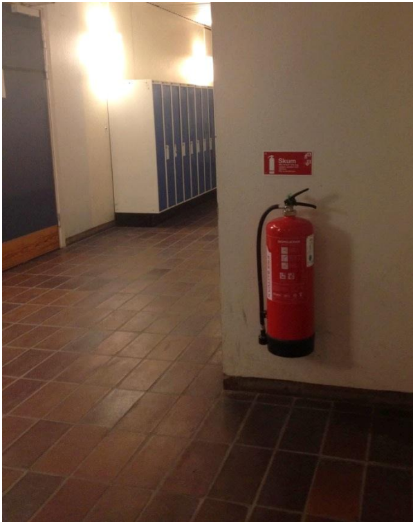
Bild 2: Tydlig placering och markering av handbrandsläckare.
