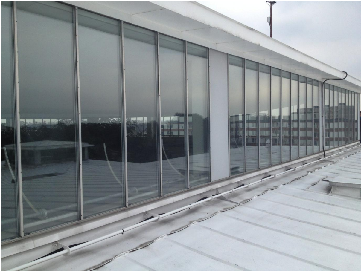
Bild 8: Mekaniskt styrda fönster för brandgasventilation av ett atrium.
