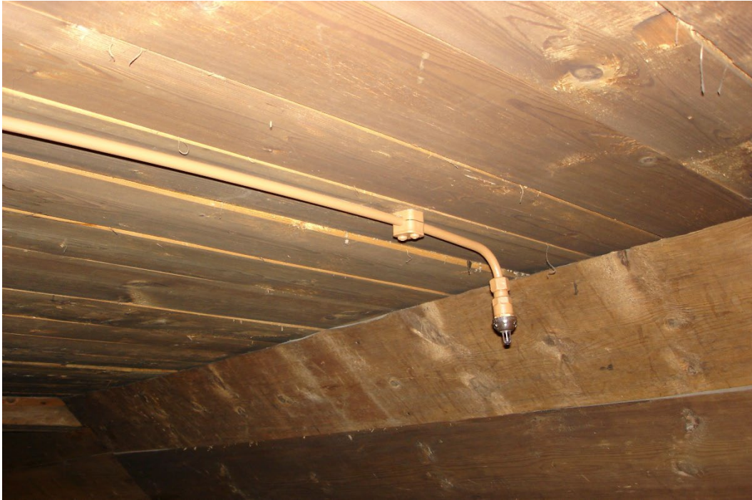
Bild 5: Installation av ett automatiskt högtrycksmunstycke (vattendimma) i en träkyrka med synlig förläggning av grenröret (Ø12 mm). Foto: Magnus Arvidson, RISE.
