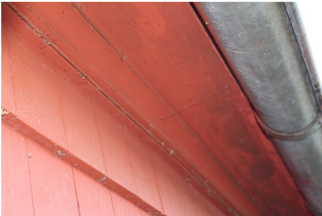
Bild 1: Värmedetektionskabel installerad under takfoten på 1600-tals träkyrka. Diskret förläggning men ej optimalt för tidig detektion eftersom kabeln ligger direkt mot underlaget och nära väggen. Foto: Magnus Arvidson, RISE.
