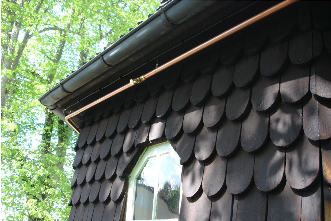
Bild 6: Ett exempel på ett sprinklersystem med öppna sprinkler installerade för att vattenbegjuta en ytterfasad på en av Sveriges äldsta träkyrkor. Sprinklersystemet aktiveras sektionsvis och automatiskt via en signal från den värmedetektionskabel som är installerad under takfoten. Här kan även noteras att sprinklerrören är tillverkade av koppar. I utomhusmiljö sker en oxidation av koppar, varvid det med tiden bildas ett mörkbrunt skikt på metallens yta som gör röret mindre synligt. Foto: Magnus Arvidson, RISE.
