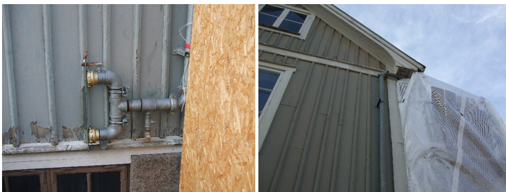
Bild 7 och 8: Anslutningspunkt och distributionsrör för fasadsprinkler vid Vaxblekaregränd i Gamla stan i Eksjö. Foto efter branden. Foto: Magnus Arvidson, RISE.
