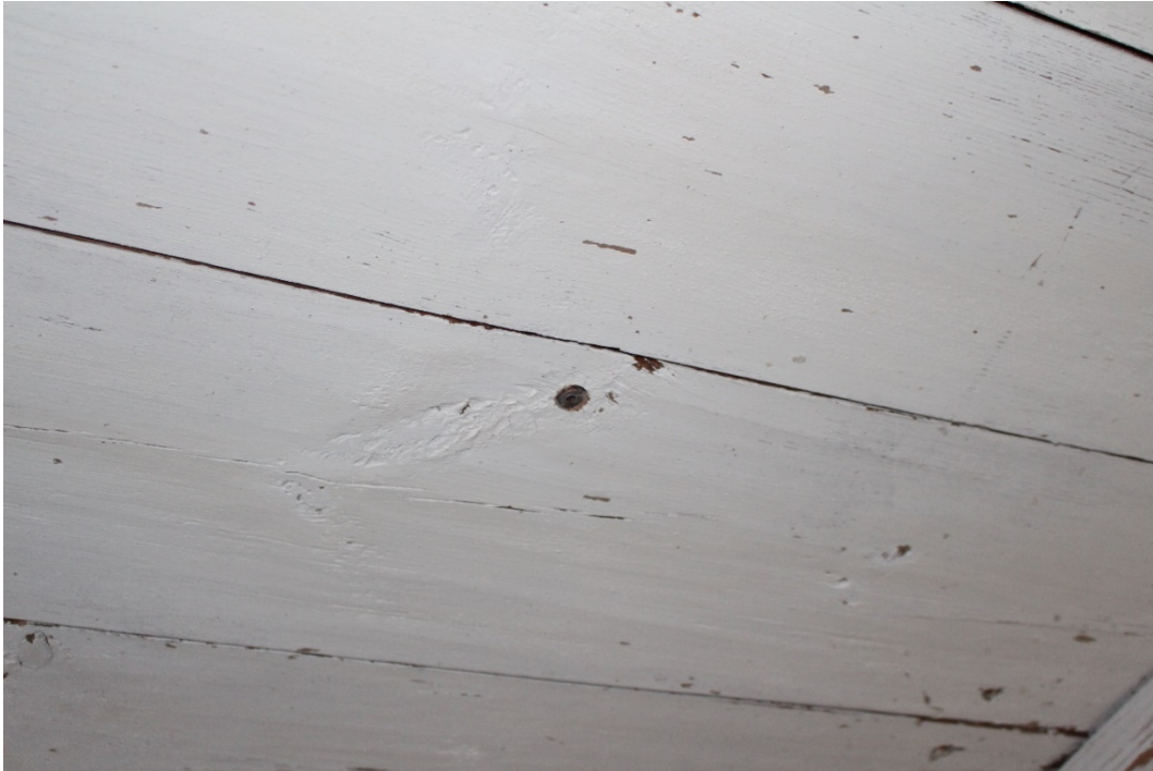
Bild 3: Dold förläggning av samplingsrör för ett aspirerande branddetektionssystem i ett golvbjälklag med samplingsöppning till röret genom takplankan. Denna förläggning kräver att golvplankor på våningen ovanför demonteras. Foto: Magnus Arvidson, RISE.
