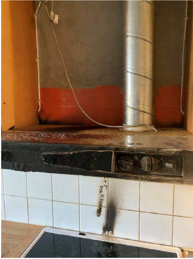
Figur B.15 – Brand med liten skada, Källa: RSG
