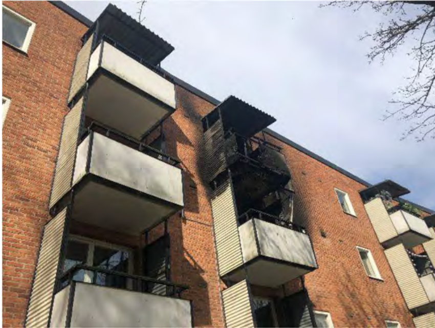
Figur B.4 – Lägenhetsbrand som sprider sig via balkong, Källa: RSG
