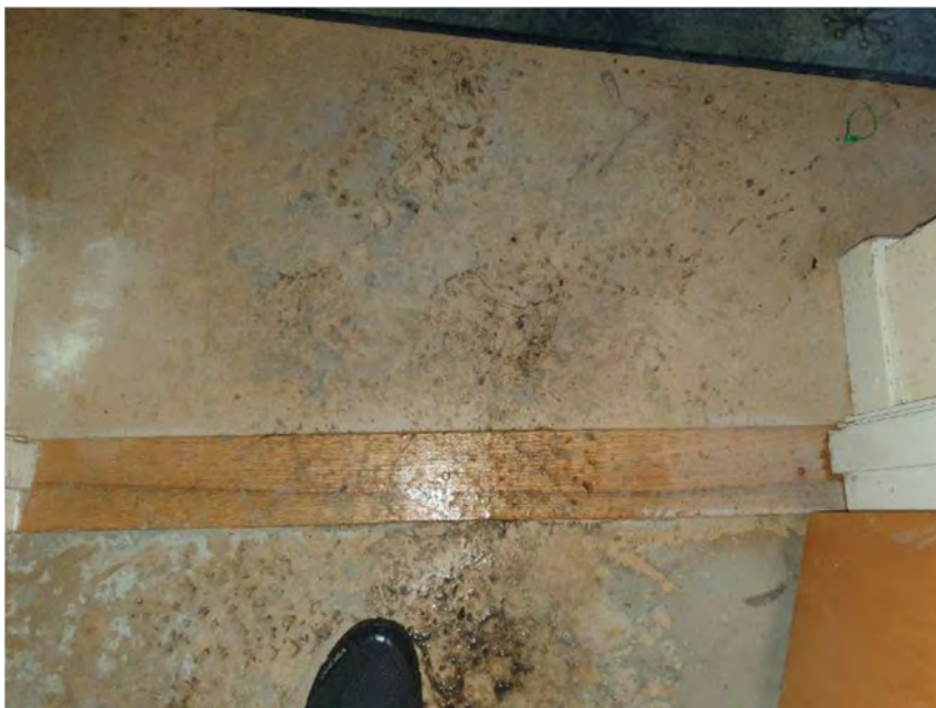
Figur B.11 – Fritt vatten på golvet, Källa: RSG
