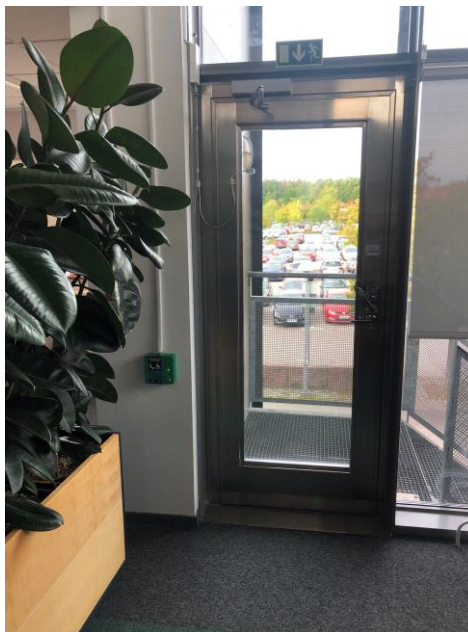
Figur 7.2 – utrymningsplats blockerad av kruka
