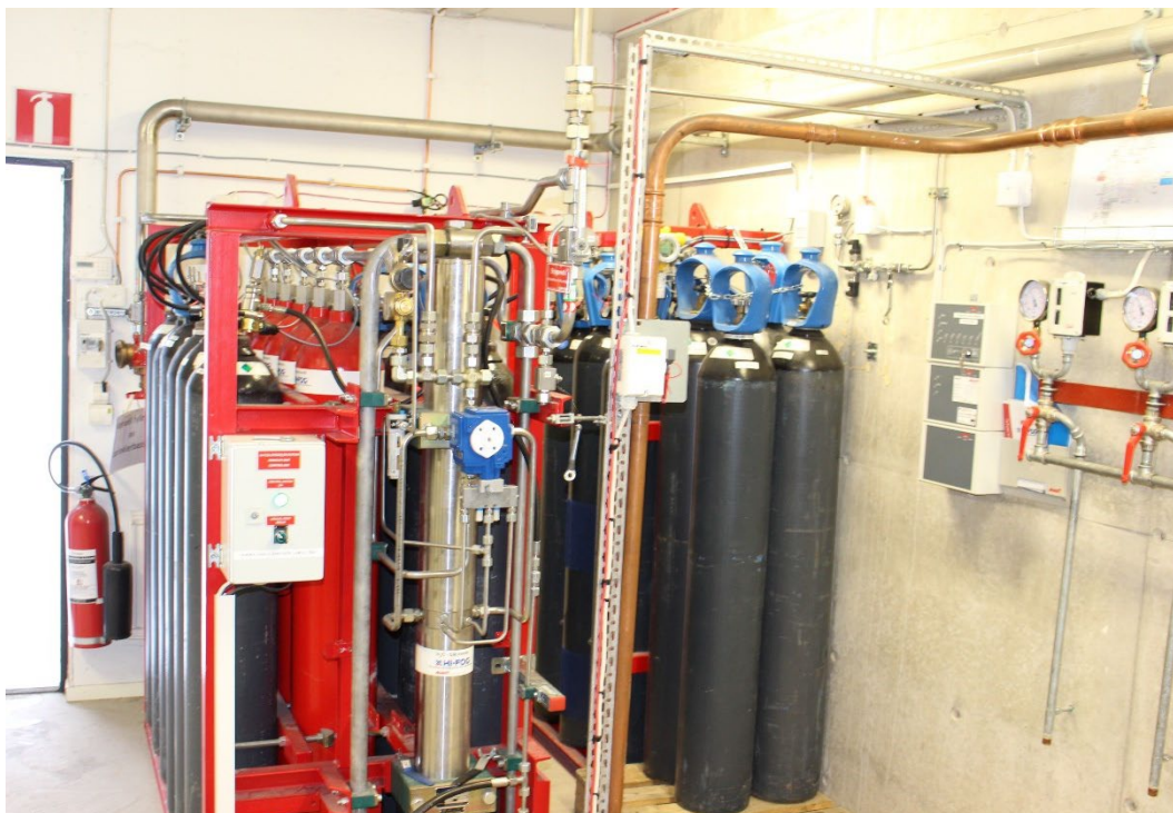
Figur 46 Gasdriven pump som drivs av kvävgas lagrade i tryckkärl. Vatten tas i detta fall från en större vattentank konstruerad av betong. Foto: Magnus Arvidson, RISE.
