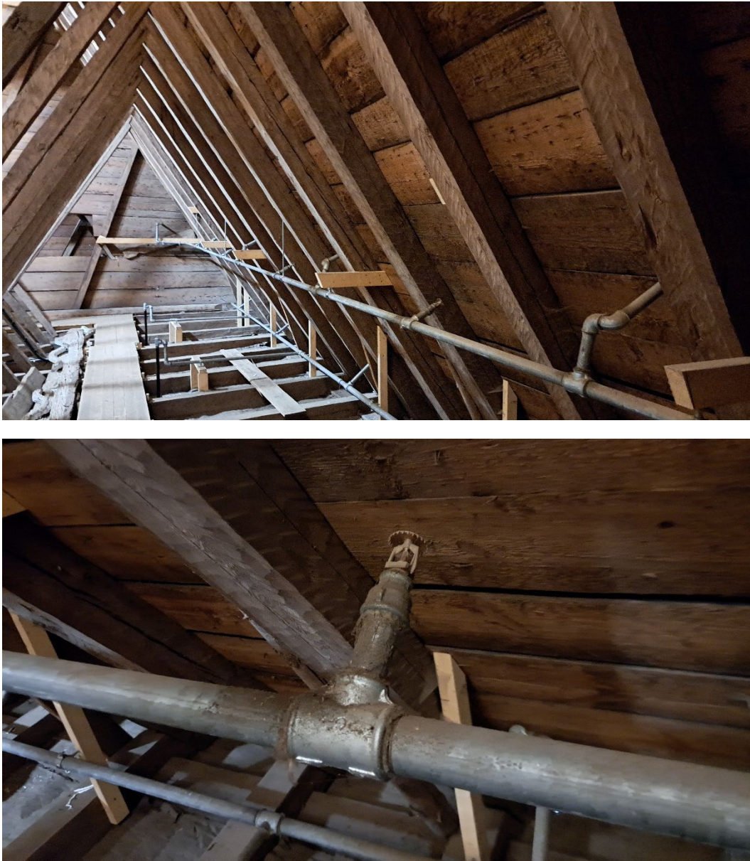
Figur 17 Sprinklerinstallation på vind med ett traditionellt sprinklersystem. Sprinklersystemet har uppåtriktade spraysprinkler (SSU) vid taknocken kompletterat med en rad (längs varje sida) med samma typ av sprinkler en dryg meter från takfoten. Här hade ett bättre brandskydd erhållits med sprinkler i varje balkfält och konventionella uppåt- eller nedåtriktade konventionella (CU/P) sprinkler för vattenbegjutning av både den invändiga takytan och takstolar. Foto: Magnus Arvidson, RISE.
