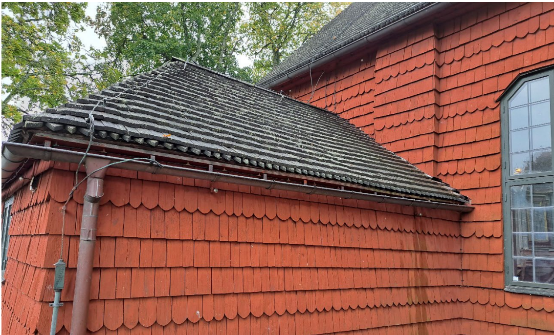
Figur 38 Ett exempel där nedledarsystemet ligger nära eller i kontakt med brännbart spåntak. Foto: Magnus Arvidson, RISE.
