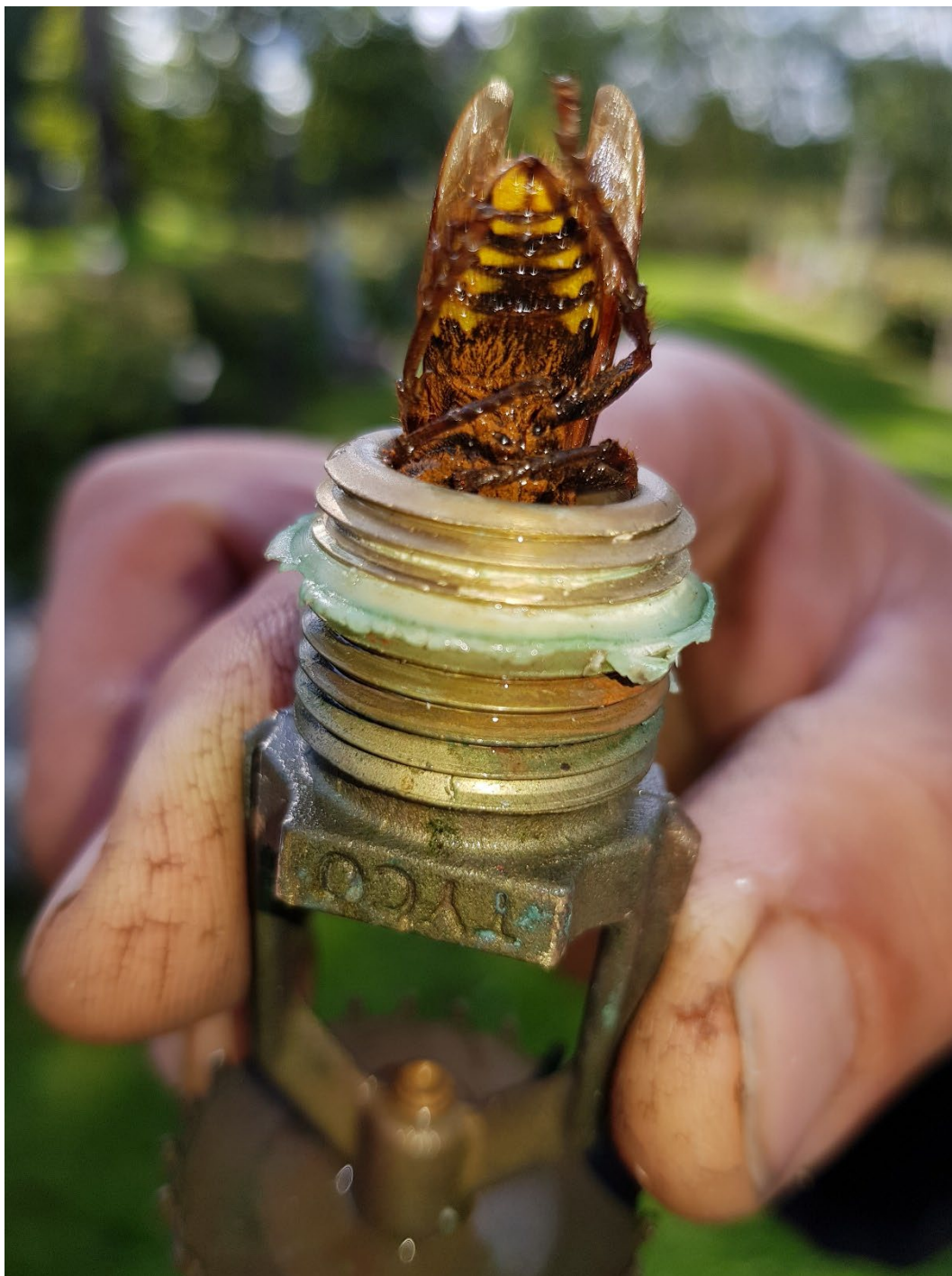
Figur 51 Igensättning av ett öppet sprinklarmunstycke för fasad där en geting krupit in genom munstyckets utloppsöppning. Igensättningen uppmärksammades när systemet provades vid en revisionsbesiktning och inget vatten distribuerades från munstycket. Foto: Tomas Godby, Brandskyddsbesiktning T Godby AB.
