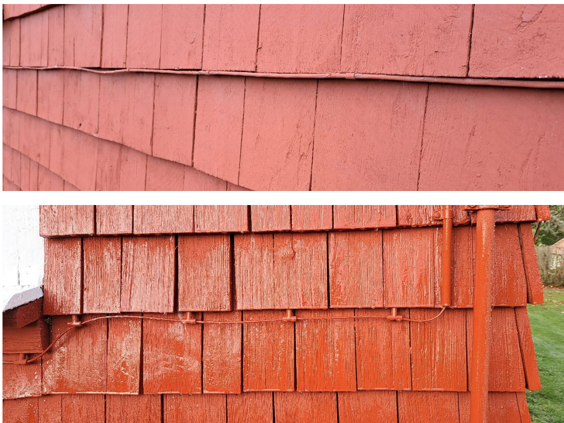
Figur 39 Två olika sätt att installera värmedetektionskablar på en fasad med träspån. Båda exemplen är från samma kyrka. Det övre fotot visar infästning med vanlig klammer (sämre lösning) och det nedre fotot visar infästning med distansklammer (bättre lösning). Foto: Magnus Arvidson, RISE.
