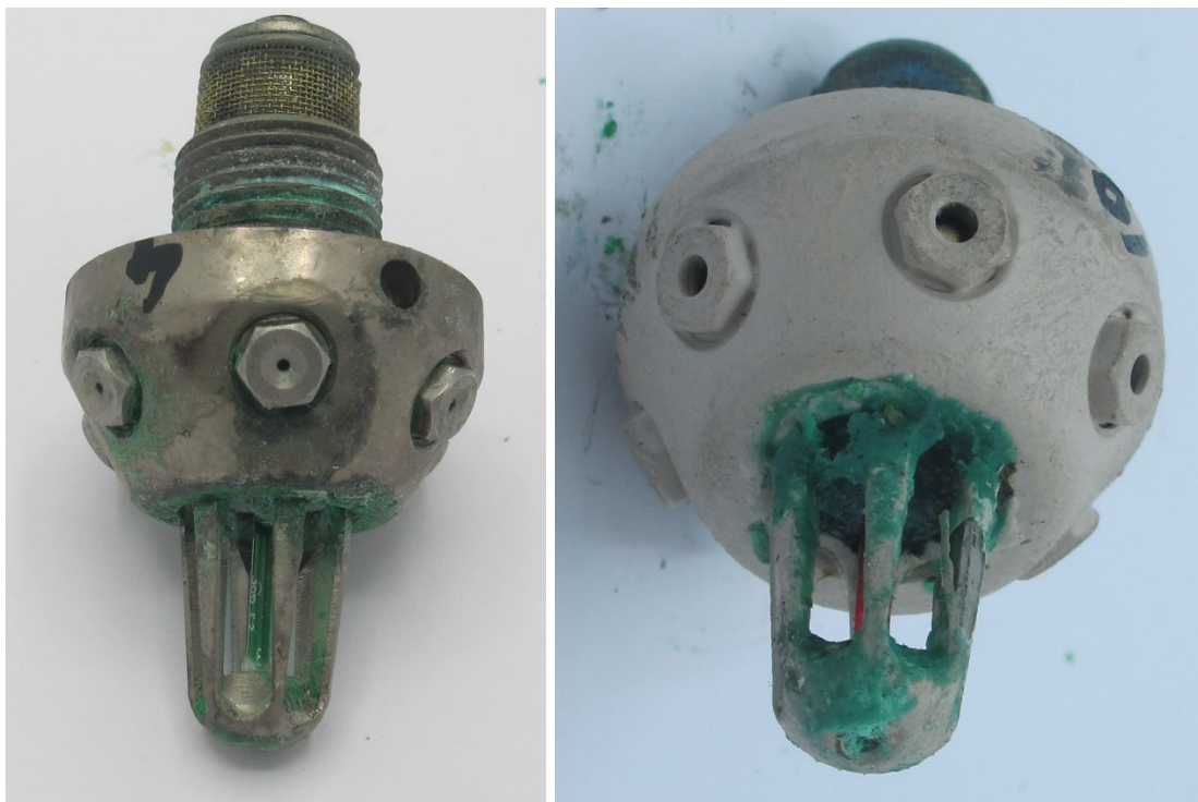
Figur 41 Automatiska högtrycksmunstycken (med glasbulb) demonterade från våtrörssystem med frysskyddsmedel. Munstyckena visar tydliga tecken på läckage i form av grönfärgade områden runt gänganslutningarna för mikromunstycken och grönfärgade saltavlagringar runt och på skyddskorgen för glasbulben. Foto: Mourhaf Jandali, RISE.
