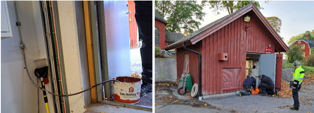
Figur 48 Anslutning av slang med korrekt typ av munstycke (vänster) till provventil för torrörssystem och mätning av tiden till vatten börjar att strömma ut genom munstycket (höger). Systemet var bristfälligt dränerat och omkring 25 liter kvarstående vatten samlades upp. Foton: Magnus Arvidson, RISE.
