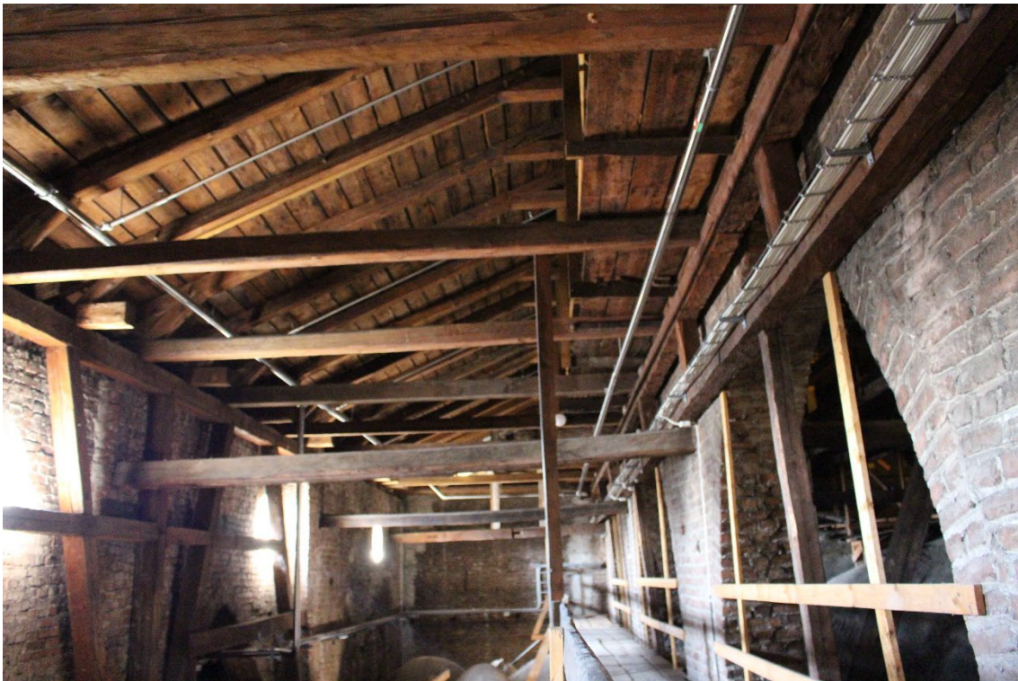
Figur 4 Vindsutrymme i en större stadskyrka. Ett traditionellt sprinklersystem (pre-actionsystem) är installerat. Sprinklerrören är av rostfritt stål. Foto: Magnus Arvidson, RISE.
