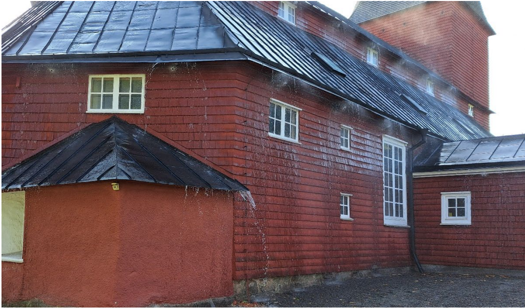
Figur 1 Utvändigt rörsystem med öppna sprinkler för vattenbegjutning av träfasaden. I just detta fall öppnas en ventil till rörsystemet när två parallella tryckluftsfyllda detektionsslangar under takfoten brinner av. Foto: Magnus Arvidson, RISE.
