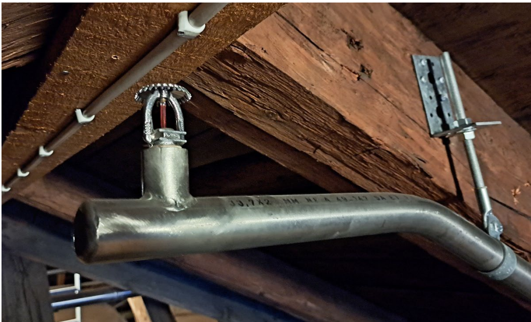
Figur 23 Grenrör av rostfritt stål i ett torrörssystem i en större stadskyrka. Här ses den infästning som ska ge mindre åverkan på trätakstolen än en traditionell infästning med fransk träskruv. Foto: Magnus Arvidson, RISE.
