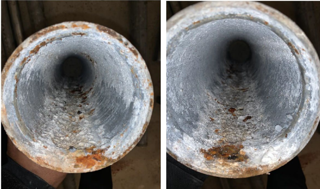
Figur 12 Exempel på invändig korrosion och hårt sittande kalkavlagringar i sprinklerrör demonterade från Marinmuseum i Karlskrona. Sprinklerrören är invändigt och utvändigt galvaniserade. Foto: Marco Belo Da Silva, AlbaCon.
