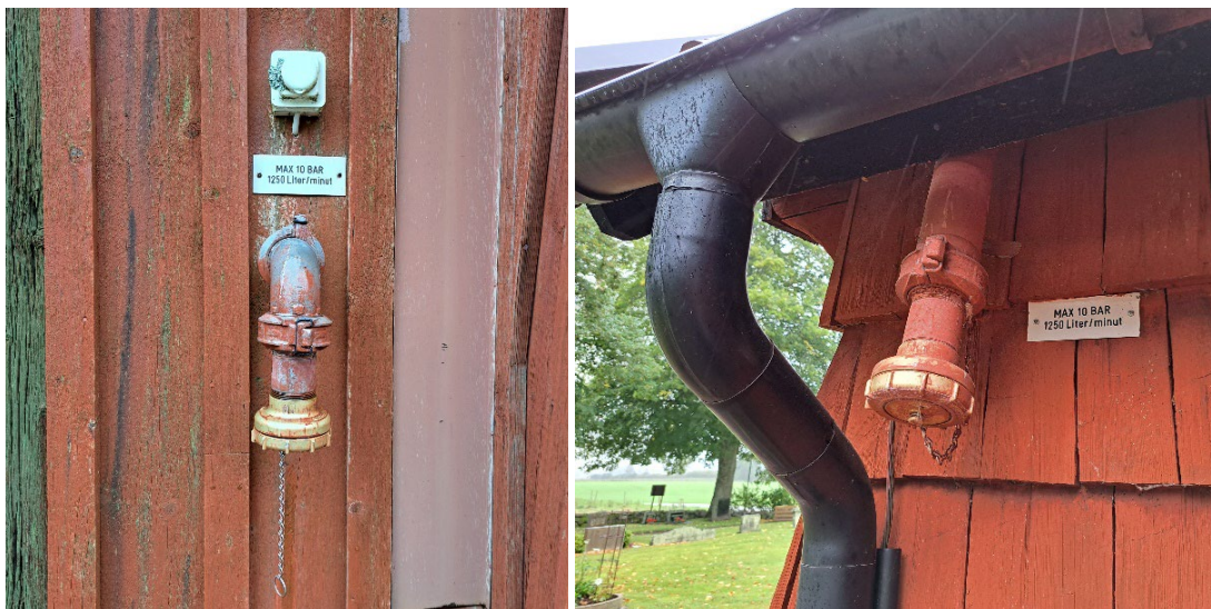
Figur 2 Anslutningar ('brandkårsanslutning') där räddningstjänsten kan ansluta brandslang kopplad till vattenpumpen på ett räddningsfordon. Rören leder vidare upp till ett rörsystem med både öppna och slutna/automatiska sprinkler i en klockstapel respektive slutna sprinkler på en kyrkvind i en kyrka från slutet av 1600-talet. Foto: Magnus Arvidson, RISE.
