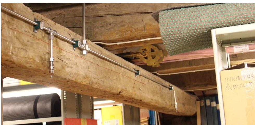
Figur 15 Automatiska munstycken (vattendimsystem) installerade långt ned från taket i ett förråd, detaljfoto. Foto: Magnus Arvidson, RISE.
