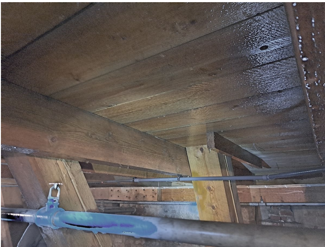
Figur 32 Vattenbegjutningen av undersidan av träbjälklaget var omfattande. Foto: Magnus Arvidson, RISE.
