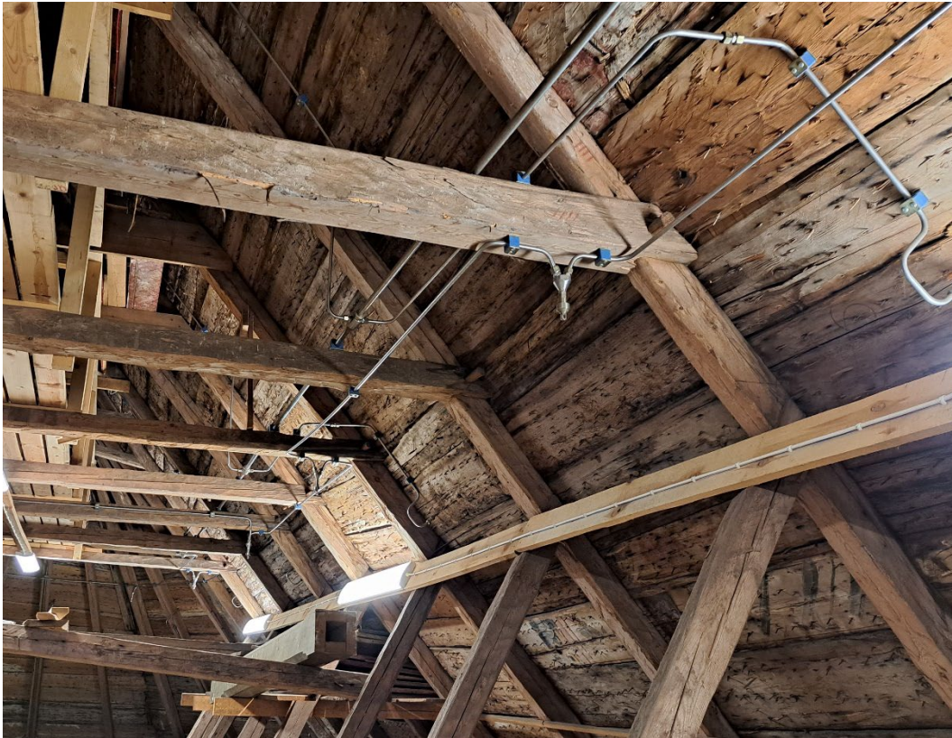
Figur 18 Ett vattendimsystem på vind. Systemet har nedåtriktade automatiska munstycken vid taknocken kompletterat med en rad (längs varje sida) med samma typ av munstycke ett par meter från takfoten. Här ses att avståndet till den invändiga takytan är långt och att det horisontella avståndet mellan munstycken är långt. Detta påverkar både aktiveringen och vattenbegjutningen negativt. Foto: Magnus Arvidson, RISE.
