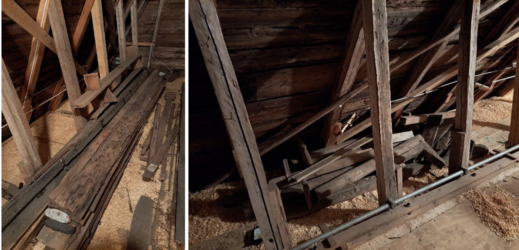
Figur 26 Exempel på lagring av brännbart material på vind. Här har plankor och annat material av trä placerats direkt på vindsbjälklaget. Det kan också noteras att bjälklaget är isolerat med såg- och kutterspån (brännbart material). Foto: Magnus Arvidson, RISE.
