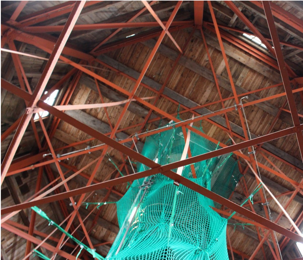
Figur 20 Ett vattendimmsystem i ett kyrktorn i en större stadskyrka. De öppna munstyckena är få och placerade så att de inte ger fullständig vattenbegjutning mot de invändiga vägg- och takytorna. Foto: Magnus Arvidson, RISE.
