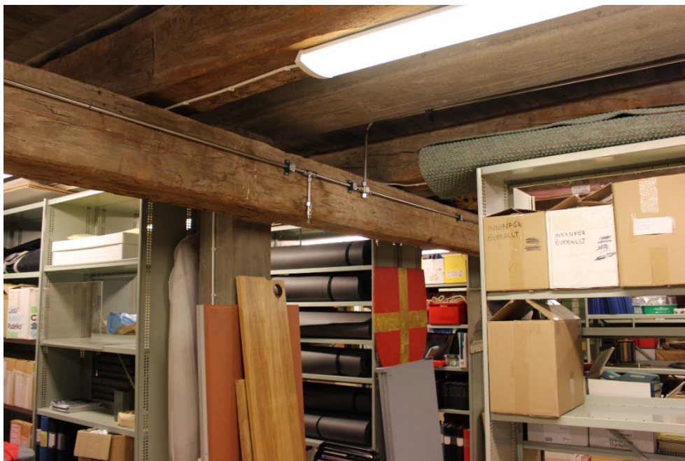
Figur 16 Automatiska munstycken (vattendimsystem) installerade långt ned från taket i ett förråd, översiktsfoto. Foto: Magnus Arvidson, RISE.
