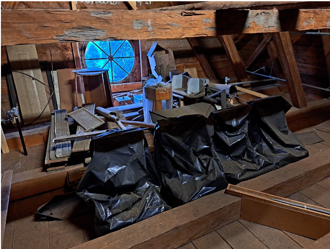
Figur 27 Exempel på lagring av brännbart material på vind. Här har plankor och annat brännbart material placerats direkt på vindsbjälklaget. De svarta plastsäckarna förhindrar förvätning av vatten från sprinkler. Foto: Magnus Arvidson, RISE.
