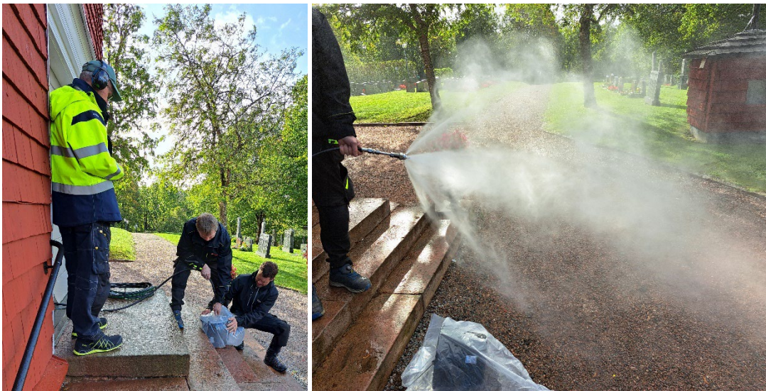
Figur 49 Anslutning av slang med korrekt typ av munstycke (vänster) till provventil för torrörssystem och mätning av tiden till vatten börjar att strömma ut genom munstycket. Systemet var bristfälligt dränerat och omkring 0,5 liter kvarstående vatten samlades upp. Foton: Magnus Arvidson, RISE.
