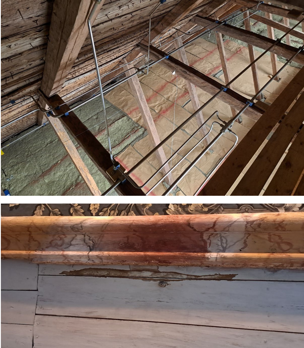
Figur 5 Delar av den mineralullsisolering i vindsbjälklaget som byttes sett från en plattform vid taknock och missfärgning av takplanka sett från kyrksalen. Mineralullsisoleringen som byttes ut är försedd med ett ytskikt av papper. Foto: Magnus Arvidson, RISE.
