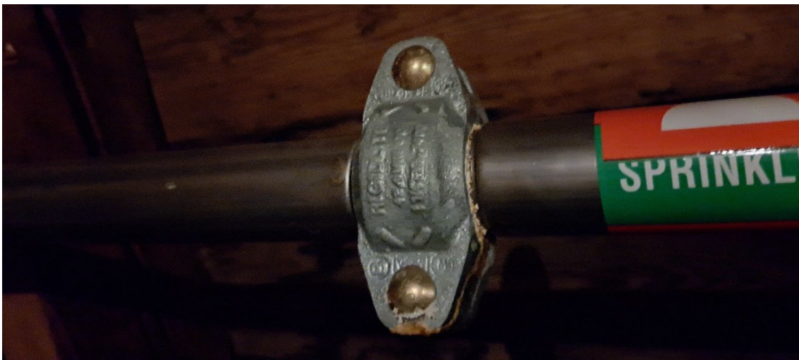
Figur 24 Grenrör av rostfritt stål i ett torrörssystem i en större stadskyrka. Här ses att installatören använt rörkopplingar av galvaniserat och inte rostfritt stål för de rillade rören. Foto: Magnus Arvidson, RISE.
