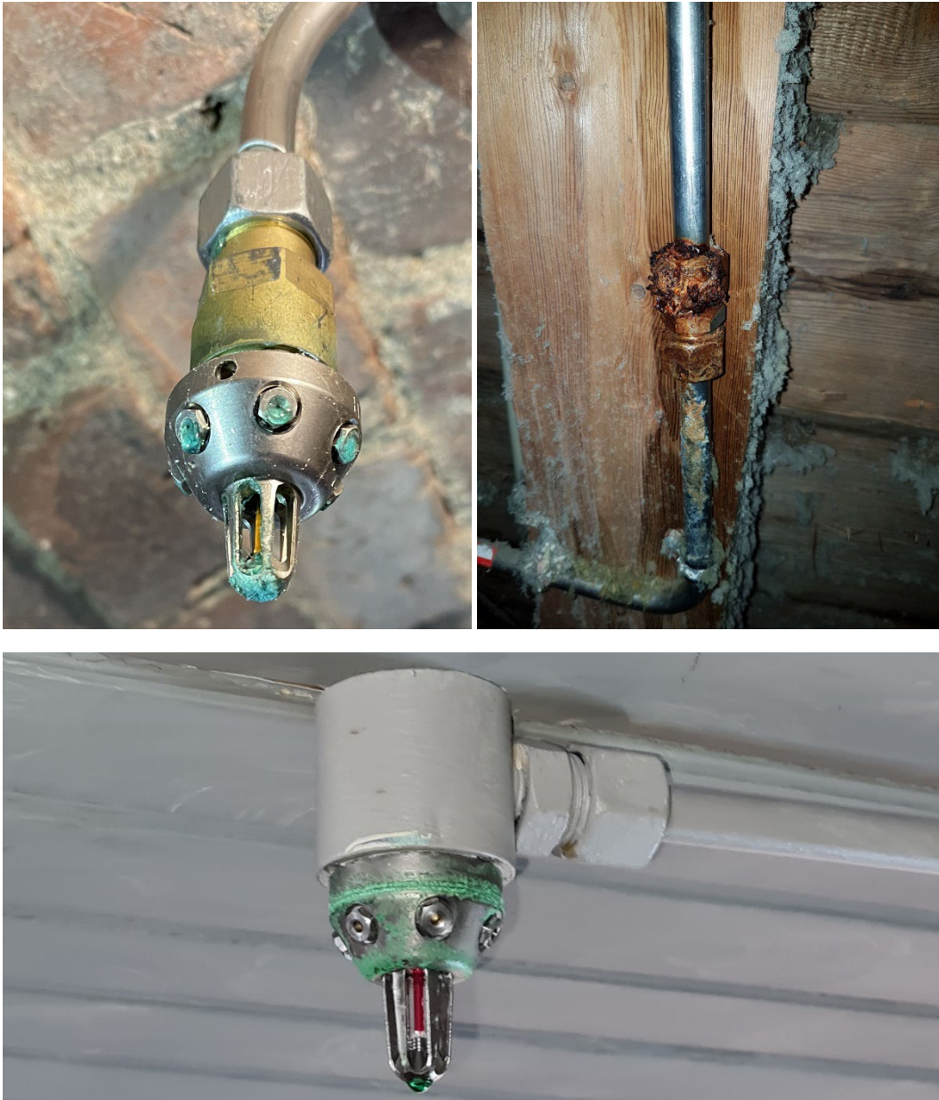
Figur 42 Ett automatiskt (med glasbulb) högtrycksmunstycke (vänster) och en rörkoppling (höger) med tydliga tecken på läckage. Det nedre munstycket är enligt uppgift tillverkat av rostfritt stål men uppvisar också tecken på läckage. Foton: Alf Thors, AT Brandskydd AB och Tomas Godby, Brandskyddsbesiktning T Godby AB.
