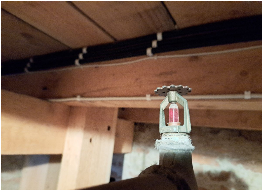
Figur 29 Sprinkler av typen nedåtriktade spraysprinkler (SSP) som har installerats uppåtriktade med avsikten att vattenbegjuta undersidan av träbjälklaget i ett kyrktorn. Sprinklernas spridarplatta är placerad cirka 300 mm ned från undersidan av träbjälklaget. Foto: Magnus Arvidson, RISE.
