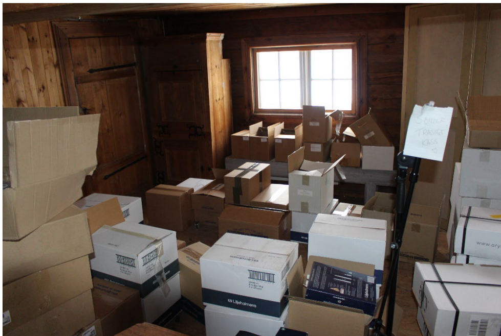
Figur 36 Lagring av brännbart material i en 1700-talskyrka som ökar sannolikheten för uppkomst av brand, intensifierar brandförloppet och försämrar möjligheten för sprinklersystemet att kontrollera branden. Foto: Magnus Arvidson, RISE.
