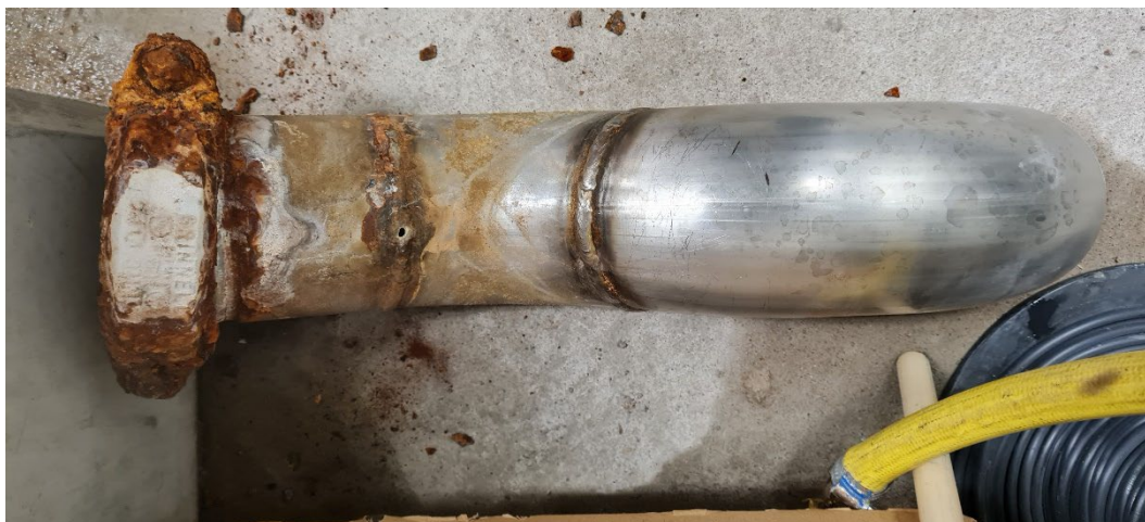
Figur 11 Genomrostning av rör av rostfritt stål, troligen på grund av galvanisk korrosion. Foto: Tomas Godby, Brandskyddsbesiktning T Godby AB.
