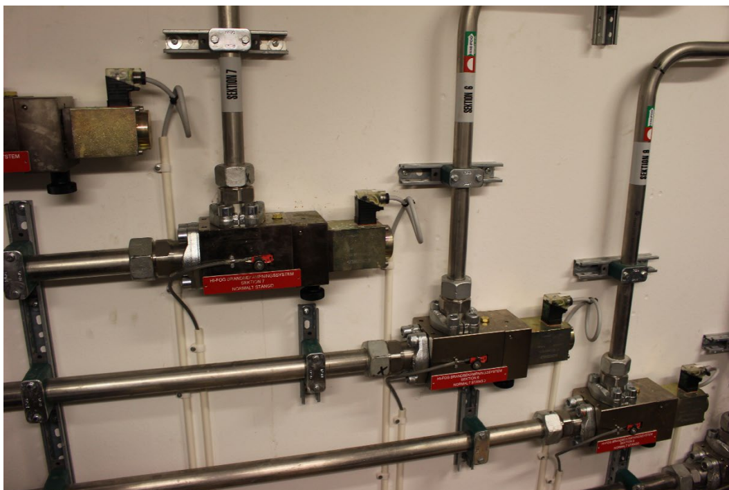
Figur 14 Sektionsventiler för ett gruppaktiveringssystem där möjlighet till provning att ventilerna öppnar vid brandlarm saknas. Det är dock möjligt att prova att magnetventilen som ska öppna ventilerna får en spänningssignal (24 V) vid brandlarm. Foto: Magnus Arvidson, RISE.
