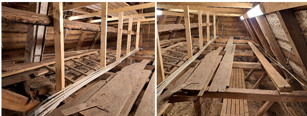
Figur 28 Exempel på lagring av brännbart material på vind. Här har plankor och annat brännbart material placerats direkt på takstolarna. Foto: Magnus Arvidson, RISE.
