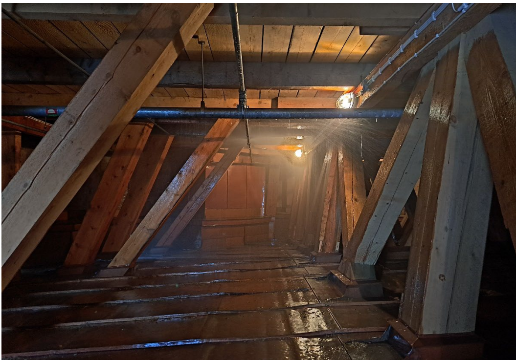
Figur 30 Aktivering av en sprinkler i kyrktornet. Här ses det invändiga falsade plåttak som förhindrar vatten att tränga ned i byggnaden. Foto: Magnus Arvidson, RISE.
