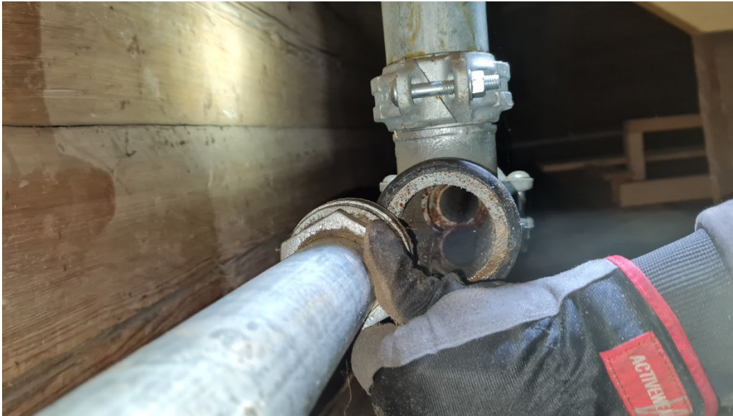
Figur 10 Kvarstående vatten i en mekanisk rörkoppling i ett torrörssystem. Foto: Tomas Godby, Brandskyddsbesiktning T Godby AB.
