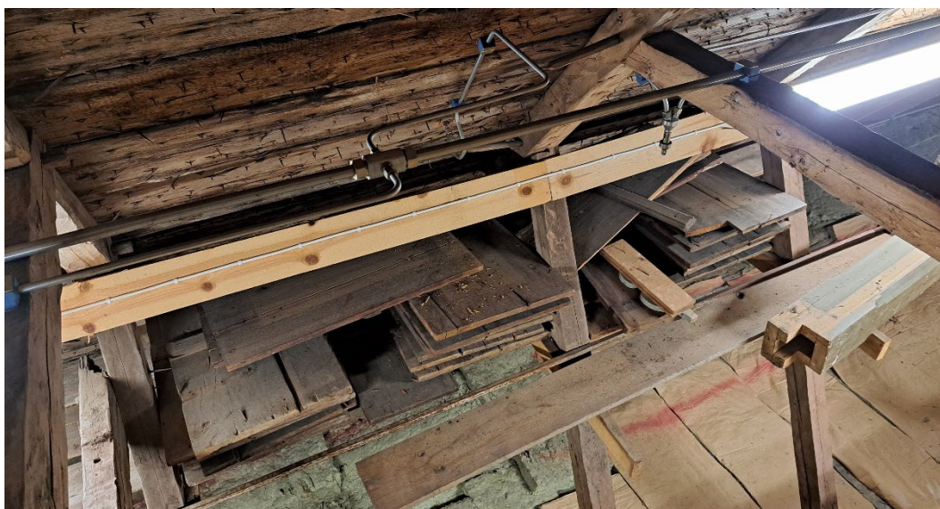
Figur 25 Exempel på lagring av brännbart material på vind. I detta fall har konsoler byggts på takstolarna vilket talar för att det någon gång i tiden betraktats som en permanent lösning. Foto: Magnus Arvidson, RISE.
