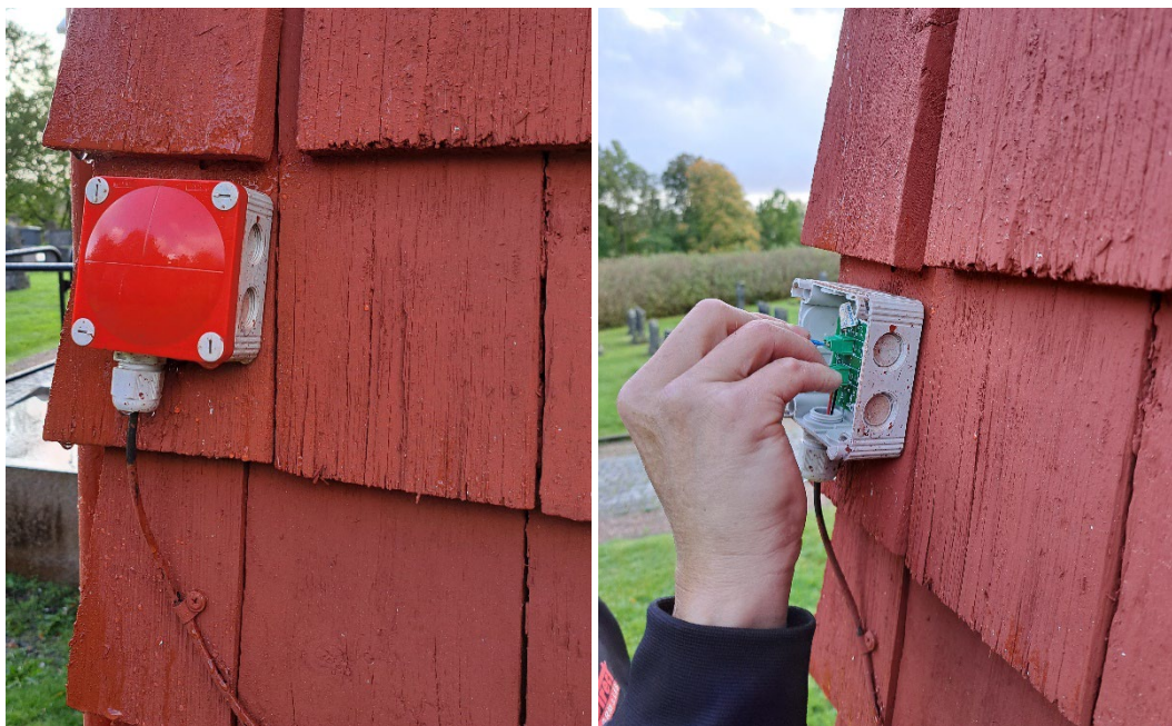
Figur 40 Kopplingsdosa med IP65-klassning och kortslutning vid prov av värmedetektionskabel. Foto: Magnus Arvidson, RISE.
