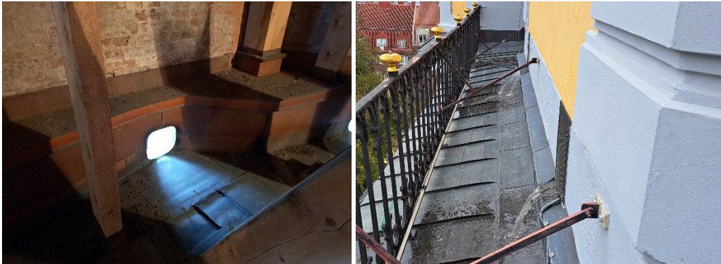
Figur 31 Avledning av vatten till yttertak och vidare ned i hängrännor och stuprör sker via gallerförsedda öppningar i kyrktornets fasad. Foto: Magnus Arvidson, RISE.
