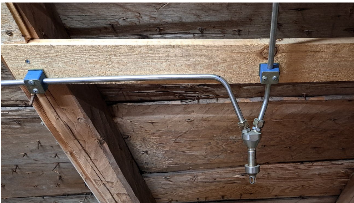
Figur 47 Två installationer med Y-koppling till ett munstycke för att säkerställa renblåsning med tryckluft av munstyckena inlopp. Foton: Magnus Arvidson, RISE.
