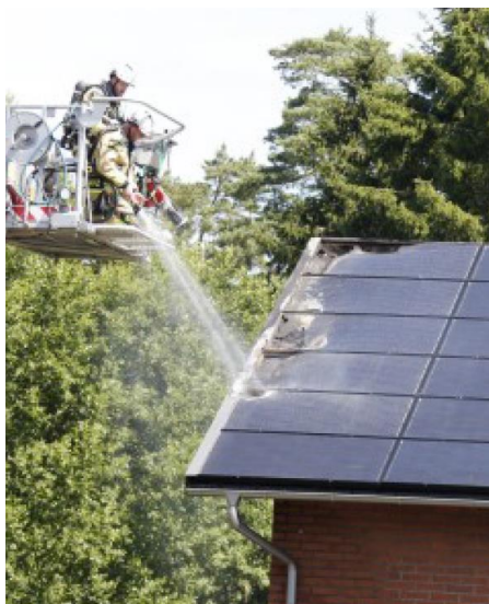
Figur 7. Brand i solcellsanläggning på villatak.
